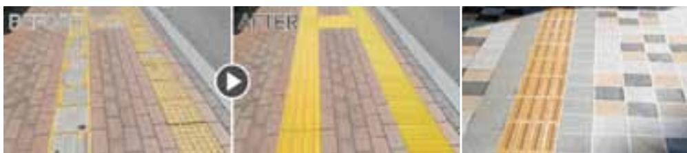
파손 및 단차로 인한 인지 불가
