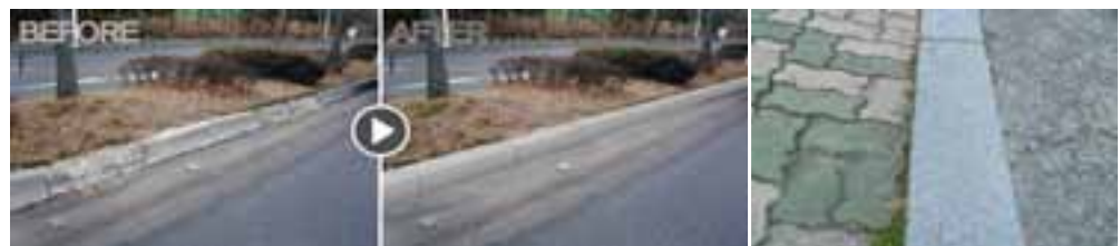
차량의 충돌 등으로 인한 파손
